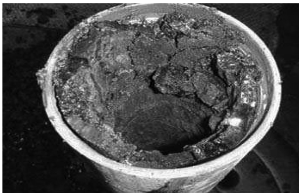
شکل ۱: بسته شدن یک لوله توسط آسفالتن‌ها
