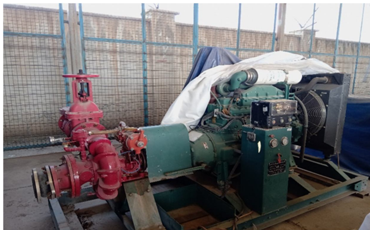
شکل 1. نمایی از پمپ و دیزل پمپ مورد مطالعه.
