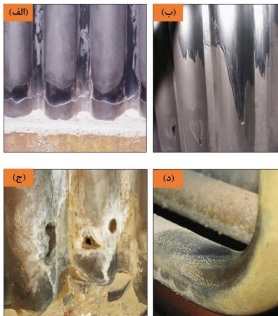
شکل 4- نمونه‌های معمول سایش فرسایشی در بویلرهای سیال شده: (الف) ناحیه روی پوشش سرامیکی، (ب) ناحیه انتقال در پوشش‌های اسپری حرارتی، (ج) آسیب ناشی از فرسایش دیوار، و (د) لوله سوپرهیتر آسیب‌دیده [24]
