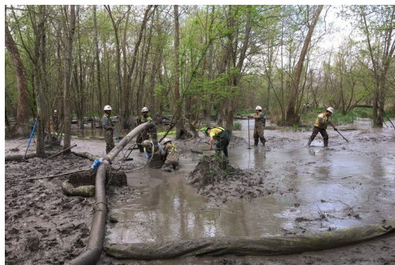
شکل 1- آلودگی محیط زیستی در اثر نشت نفت از خط لوله
