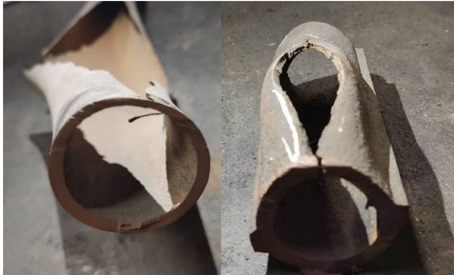
شکل 6- اورهیت شدن لوله‌های واتروال واحد نیروگاه بخار
