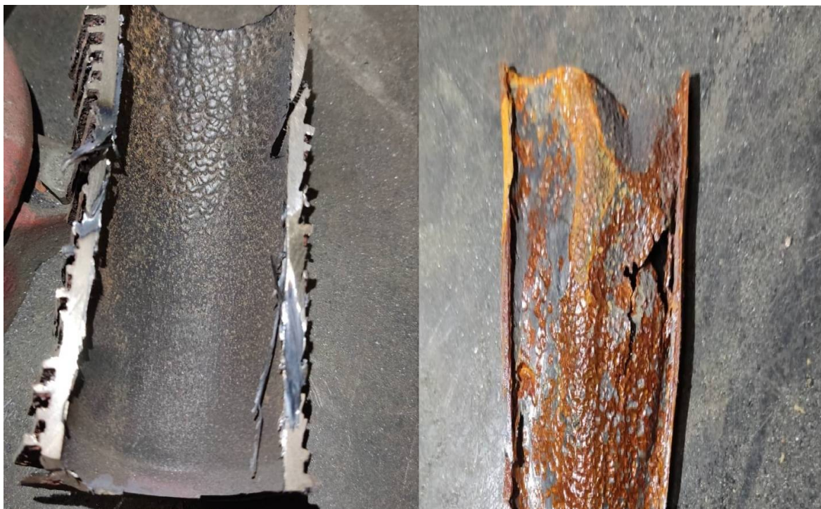
شکل 7- خوردگی FAC در لوله های اکونومایزر واحد نیروگاه بخار
