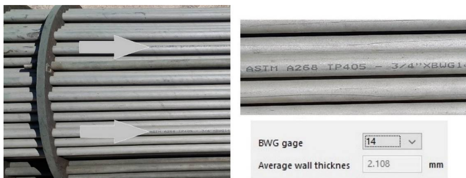
شکل 5- ضخامت لوله‌های اولین گذر لوله در دسته لوله مربوط به مبدل حرارتی نفت خام - نفت گاز
